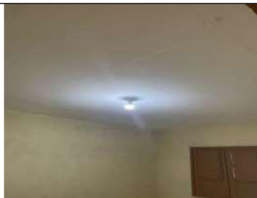
FIGURA 08: Casa com forro de gesso e energia elétrica.
